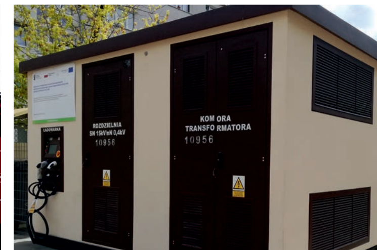
Stacja SPS dla innogy. Innogy SPS station in Warsaw.
